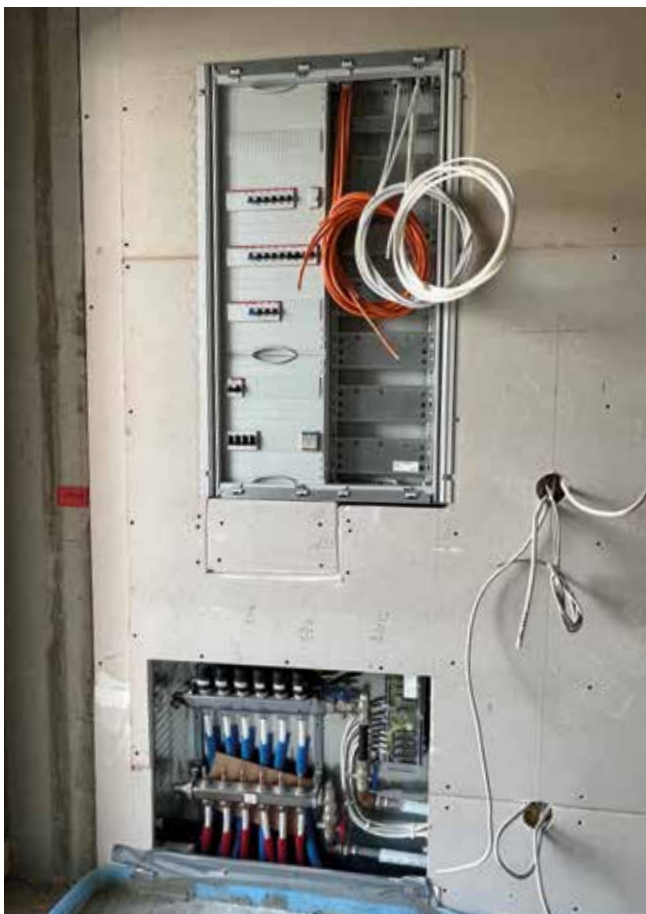
Zukunftsfähige haustechnische Installation
