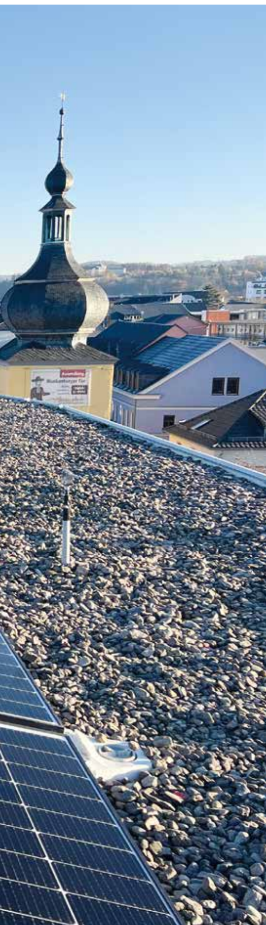
PV-Anlage Dach Friedensstraße 12
